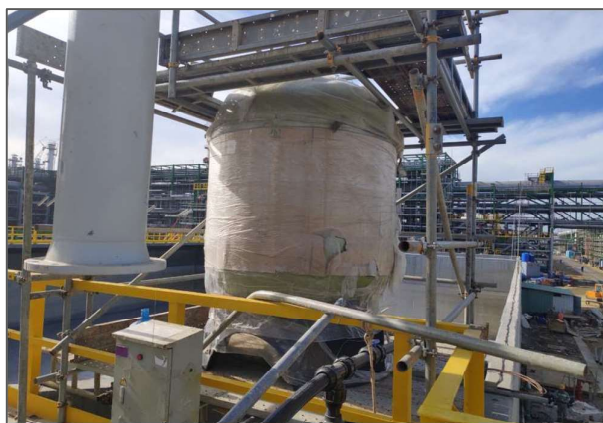
Hình 4. Bồn lọc than hoạt tính
